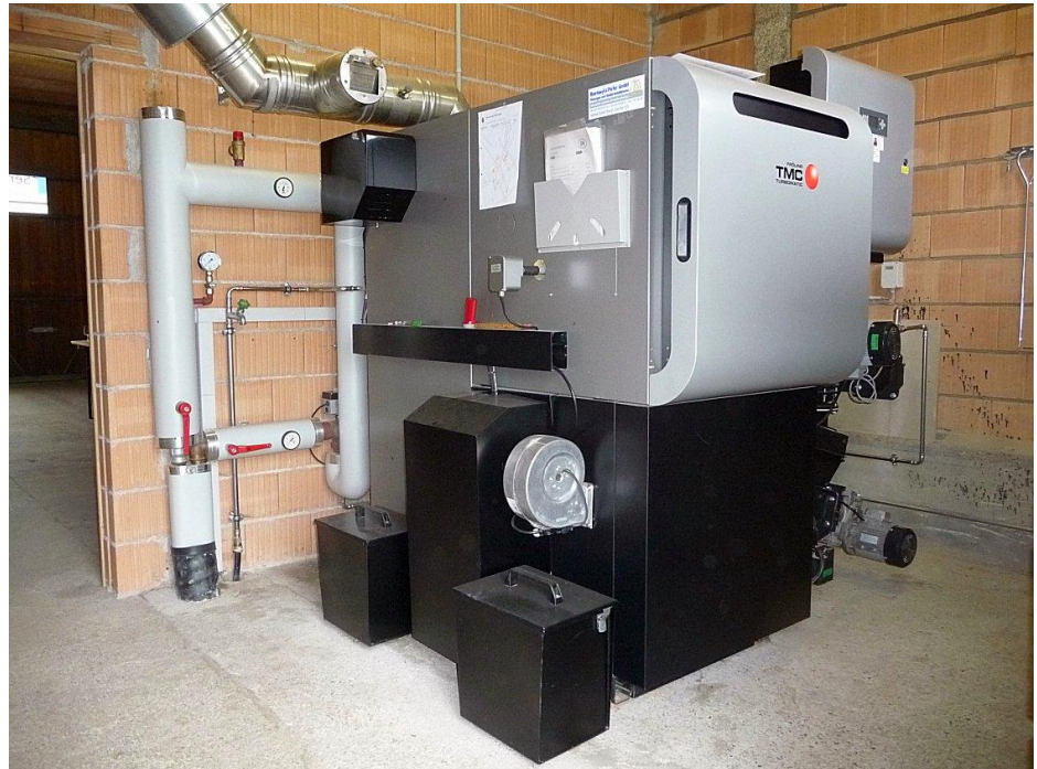
Abbildung 74: Nebst den grösseren Holzwärmeverbänden bestehen im Sensebezirk eine Reihe weiterer kleinerer Anlagen wie dieser Heizkessel mit einer Leistung von 100 kW (Baujahr 2009) im Weiler Litzistorf (Bösingen). Photo: M. Gutschner
